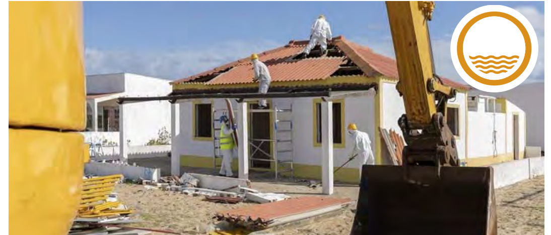
Relocalização da ocupação para zonas sem risco
